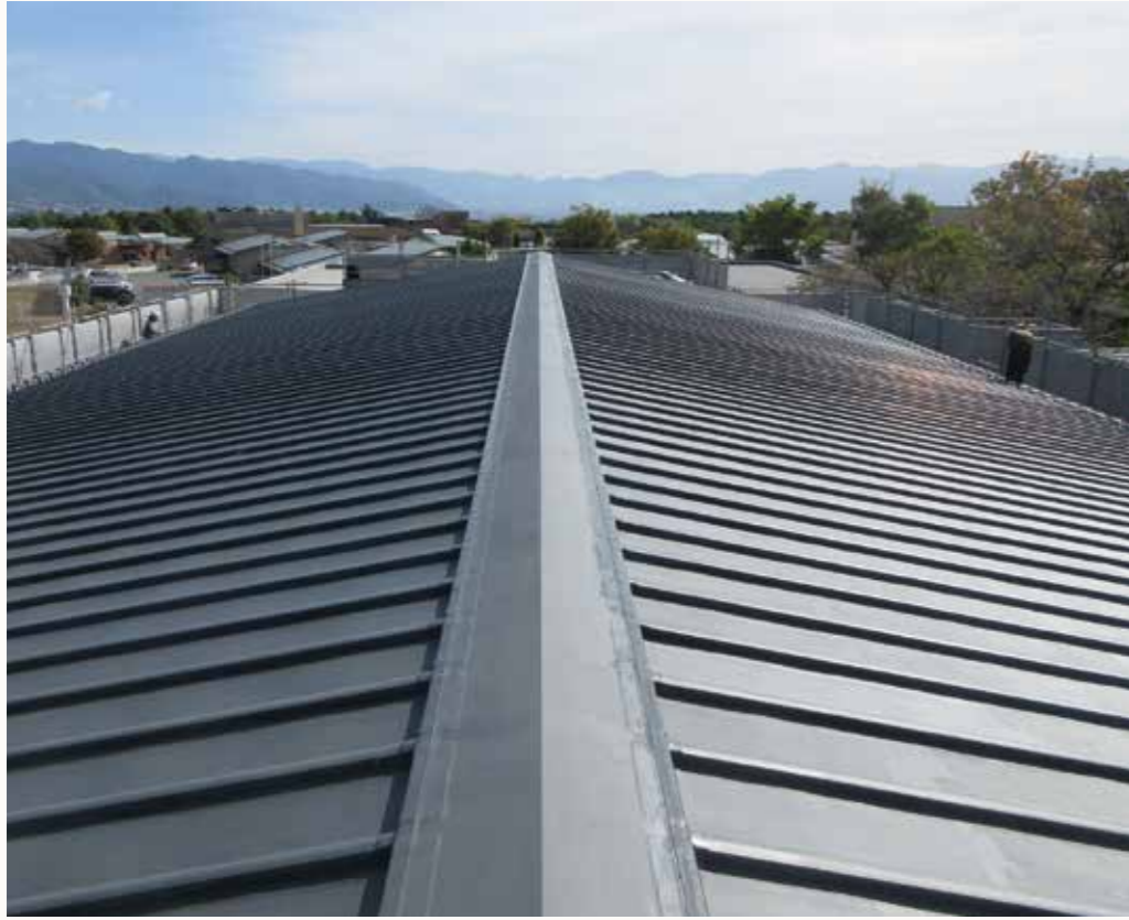
山梨県立あけぼの支援学校 加硫ゴム系シート防水接着工法（金属下地）
