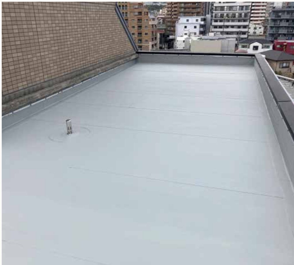
神戸市某ビル屋上防水改修 加硫ゴム系シート防水 簡易脱気工法（コンクリート下地）
