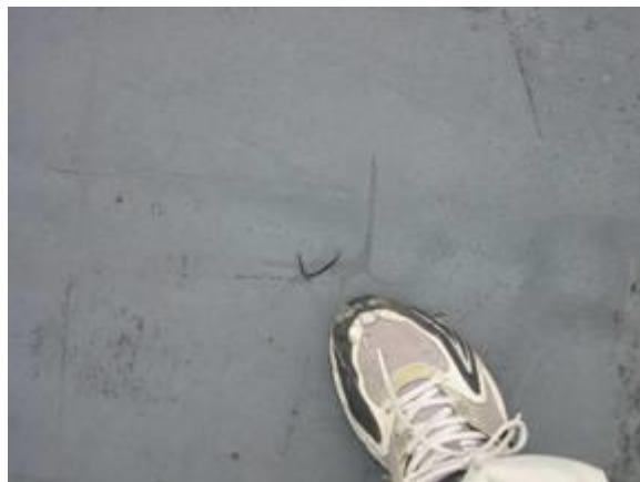
劣化度Ⅲ 損傷有り
