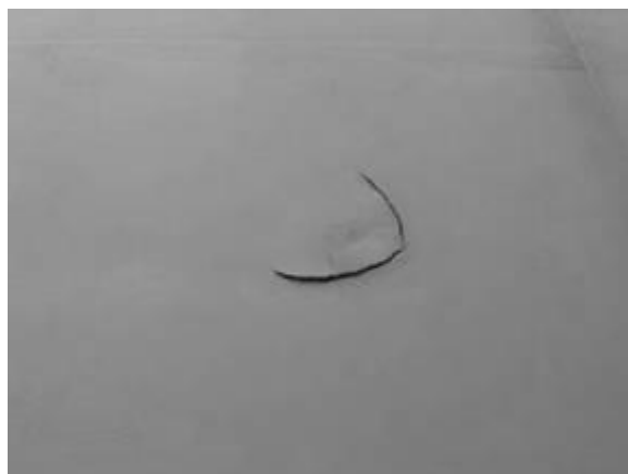
劣化度Ⅲ 損傷有り
