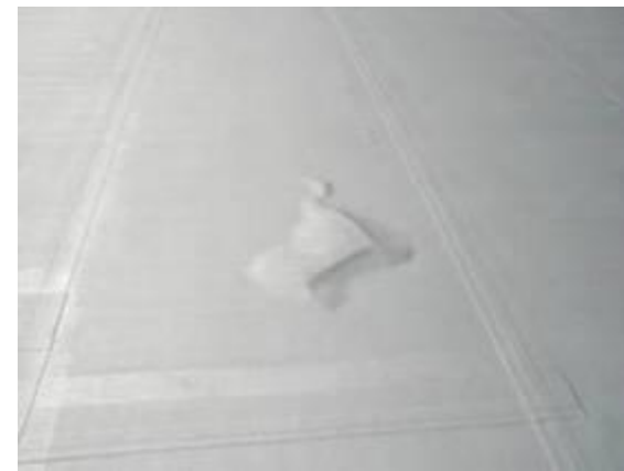
劣化度Ⅰ 面積比:10%未満
