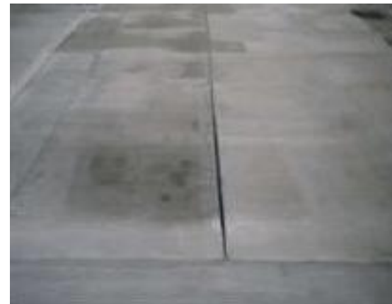
劣化度Ⅰ 接合幅の20%未満
