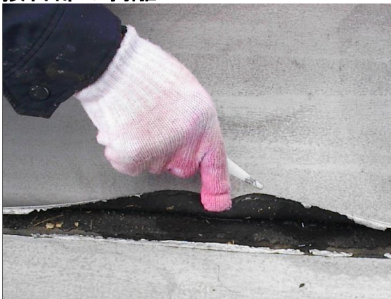
劣化度Ⅲ 接合幅の50%以上
