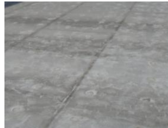
劣化度Ⅰ 問題なし
