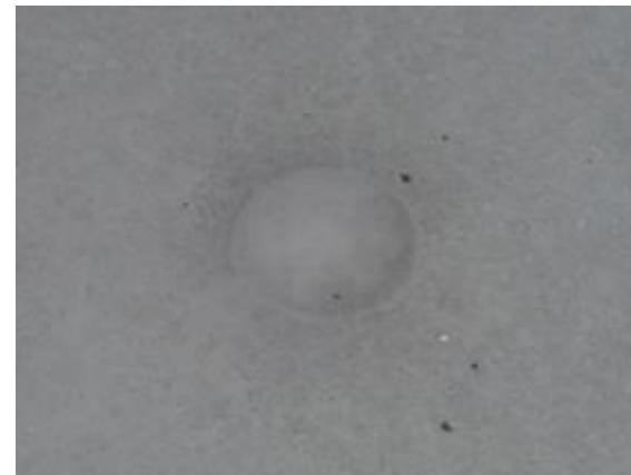
劣化度Ⅰ 問題なし
