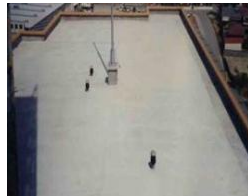
劣化度Ⅰ 保護仕上げ層の変退色
