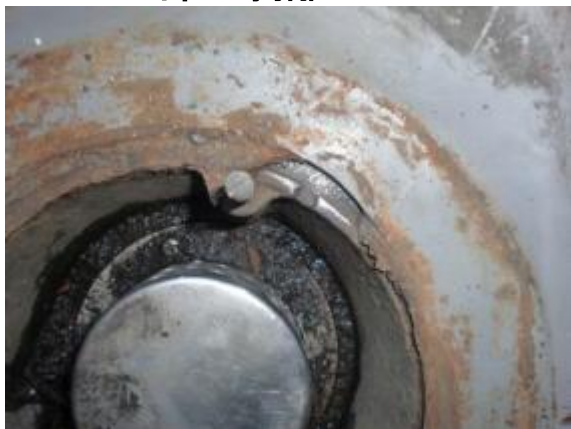
劣化度Ⅲ 剥離有り
