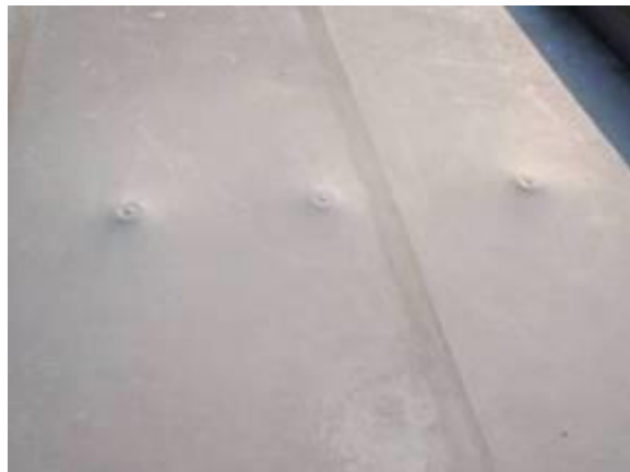
劣化度Ⅲ 固定金具浮き
