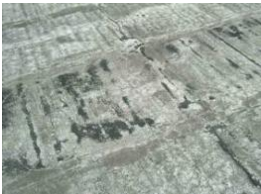
劣化度Ⅲ 保護仕上げ層の消失
