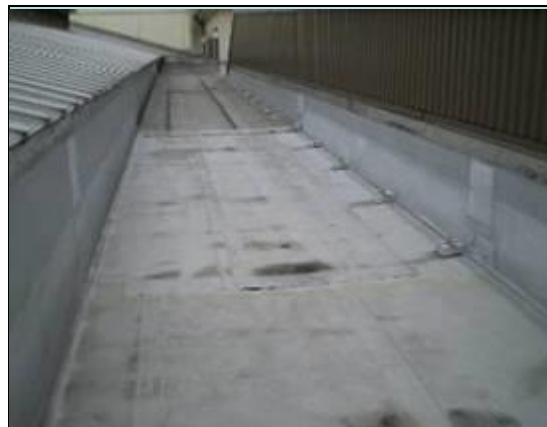
劣化度Ⅱ 接合幅の50未満～20%以上
