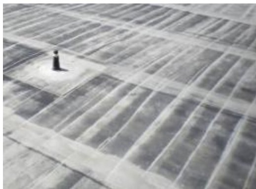
劣化度Ⅲ 保護仕上げ層の消失
