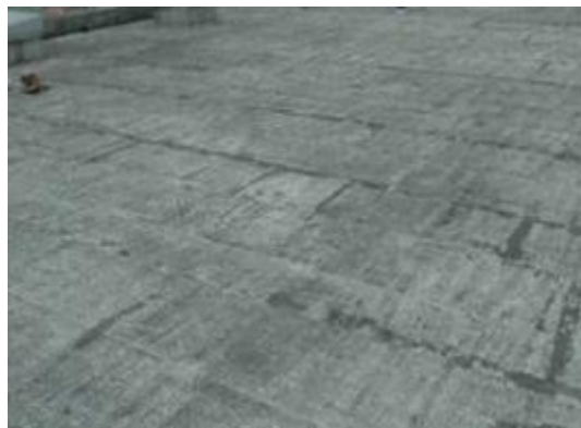
劣化度Ⅱ 保護仕上げ層の摩耗・白亜化
