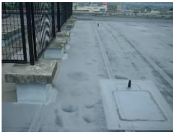
劣化度Ⅲ 面積比:30%以上
